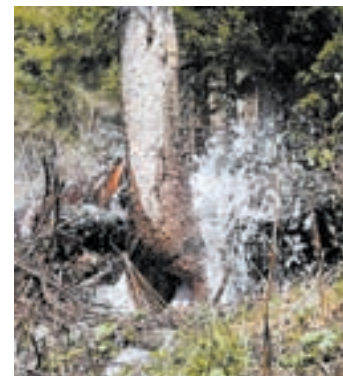
Der Hang ist mit Bergwasser gefüllt, das nicht einfach abgeleitet werden kann. Foto: Schnegg
